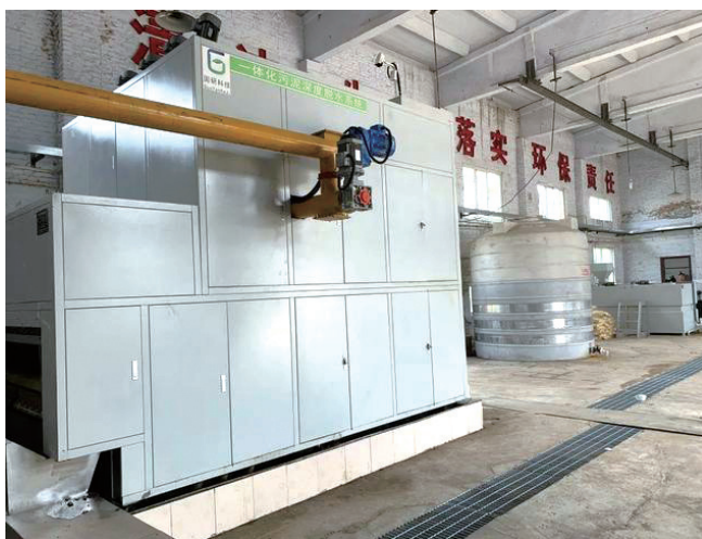
2020 年 06 月 25 日，濮新水务有限公司一体化污泥深度脱水设施投入使用
